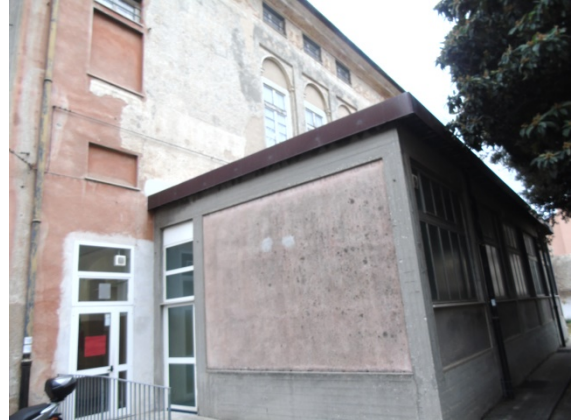
Figura 4.1 - Particolare della porzione di involucro – parete verticale opaca sia del corpo scuola sia della palestra annessa successivamente
