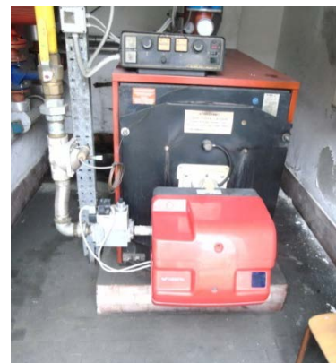
Figura 8.3 – Sistema di generazione obsoleto da sostituire
