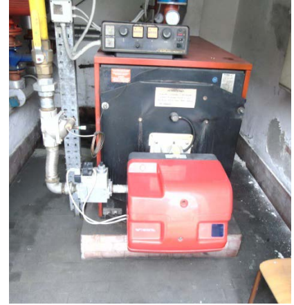
Figura 8.5 – Sistema di generazione obsoleto da sostituire
